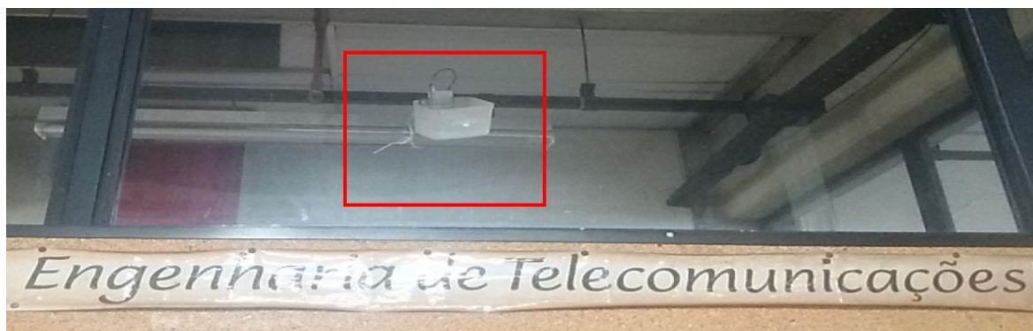
Figura 82. Rádio ID3 fixado no quinto andar do Bloco D da Escola de Engenharia da UFF, Niterói, RJ.
