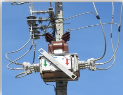
Figura 7 - Exemplo de chave telecontrolada
