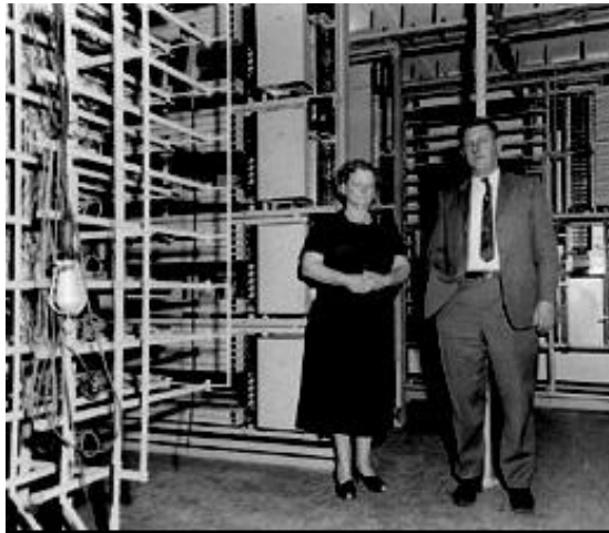
Figura 7: Central de comutação automática dos anos 50. http://www.international-phone-card.info/images/telephone_history/lewis-xy.jpg
